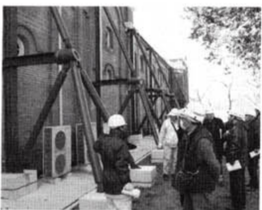
内部の補強鉄骨材を保持する外側に取り付けられた支柱。
