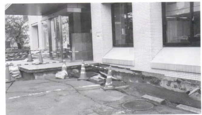
建造物の被害
