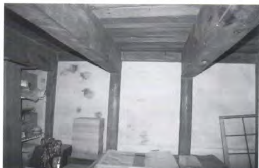
Staining from rainwater / 雨水によるしみ
